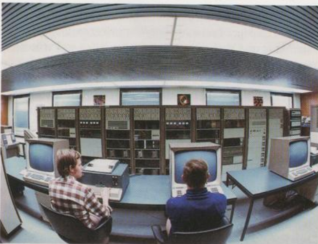
Automatische Fernmelde- und Speichervermittlung (AFSV) im Nachrichtenzentrum des DWD
