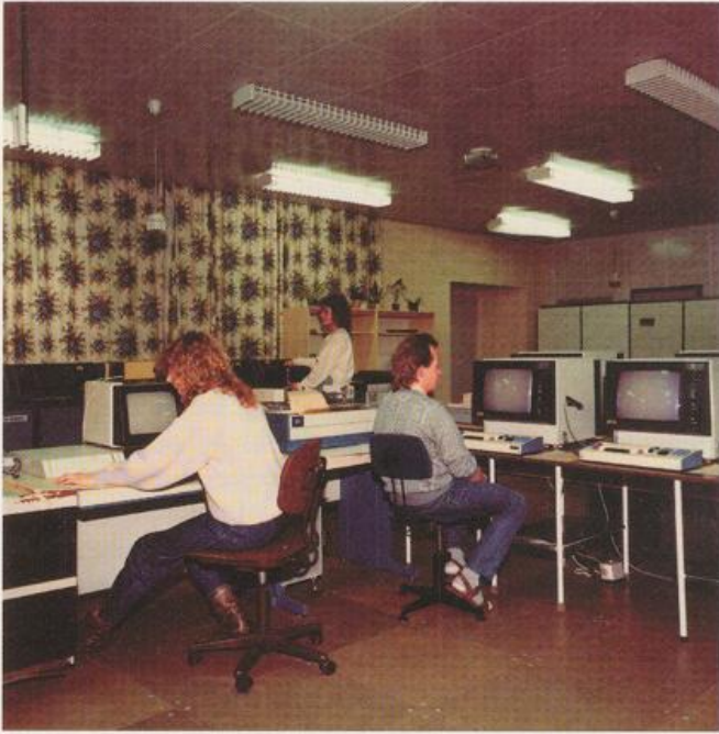
Teilansicht des Rechenzentrums des MD in Potsdam
