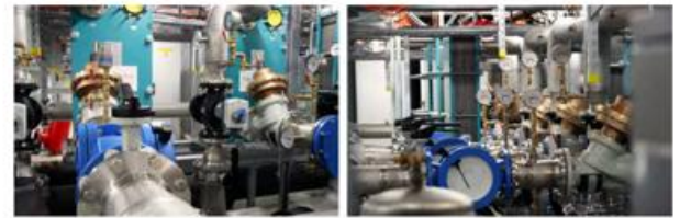
Das neue Kühlsystem im Untergeschoss des Deutschen Meteorologischen Rechenzentrums Quelle: Susanne Stammwöl (DWD)
