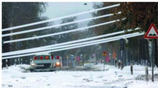
Abb. 3 In Folge der enormen Lasten bis fast auf die Straße herunterhängende Freileitungen im Münsterland
