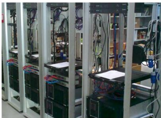
◀ Neue ASDUV-Anlagen vor Auslieferung
