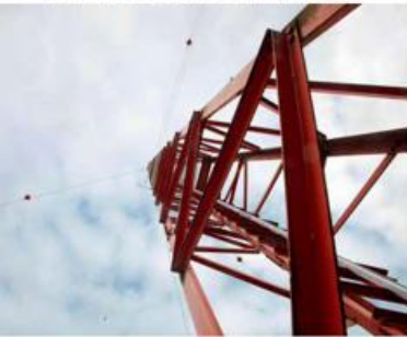
Antennenmast an der Wetterfunktendestelle Pinneberg
