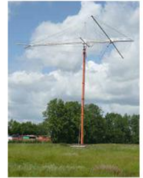
Antenne an der Wetterfunkstation (WFS) ▼ Pinneberg des DWD
