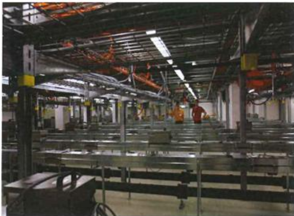
Infrastruktur (Netzwerk, Strom, Klimatisierung)
