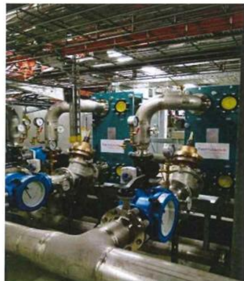
Klimatechnik (Kaltwasserkühlung CRAY XC40)
