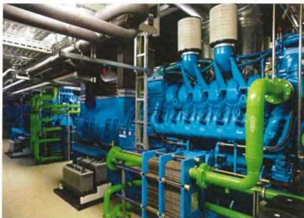
Notstrom-Generatoren Fa. MTU
