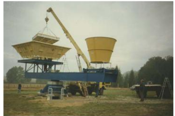
Abb 1: Installation des 1290 MHz WPR am Observatorium Lindenberg im Oktober 1993
