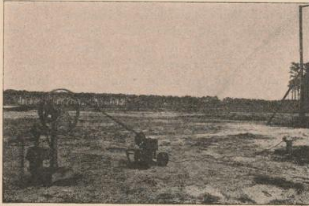
Kolonialpumpe mit fahrbarem Elektromotor.
