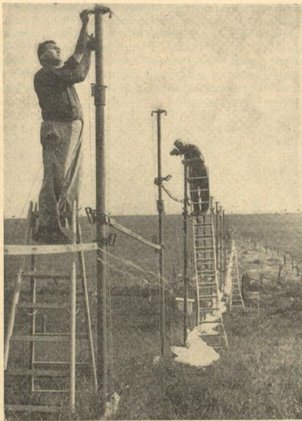
Abb. 10 Aufbau des 5 m hohen Stauhindernisses in einem Tal bei Losheim (Eifel) zur Untersuchung des Kaltluftflusses an Straßendämmen
