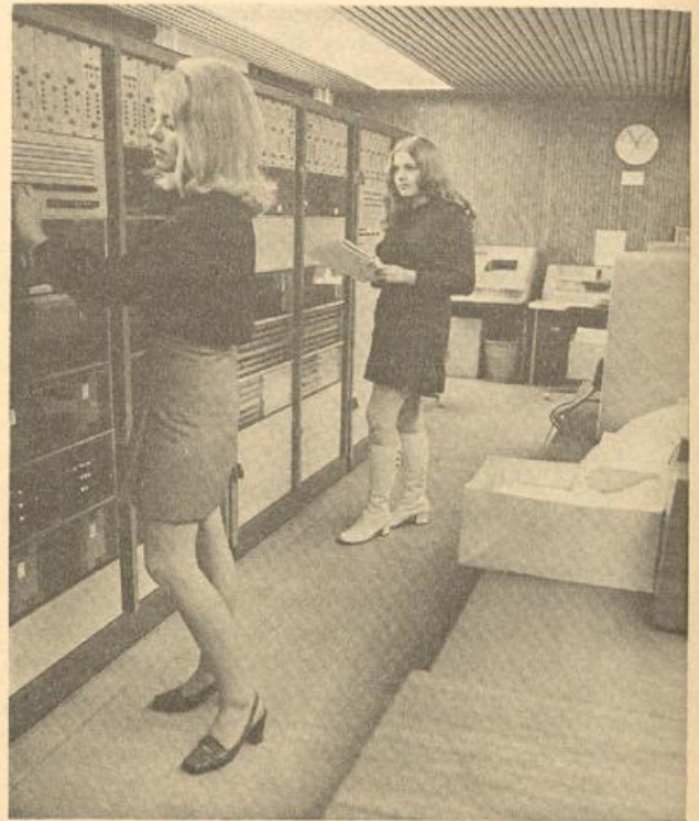
Abb. 18 Betriebsraum der Automatischen Fernschreib-Speicher-Vermittlung
