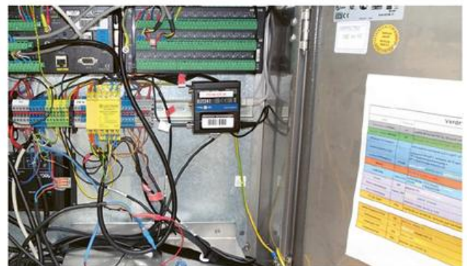
Das Innenleben des Stationsgehäuses einer mobilen Wetterstation. Foto: MME
